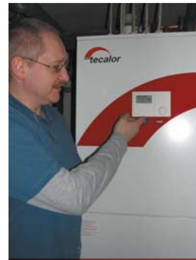
Heizkörper gibt es nicht mehr; ein Gerät im Keller regelt die Wärme- und Wassertechnik fürs ganze Haus.
